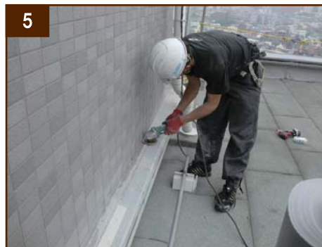
5 （目地新設） 納まりの悪い箇所は目地を新設し防水端末を躯体内で納める処理をします
